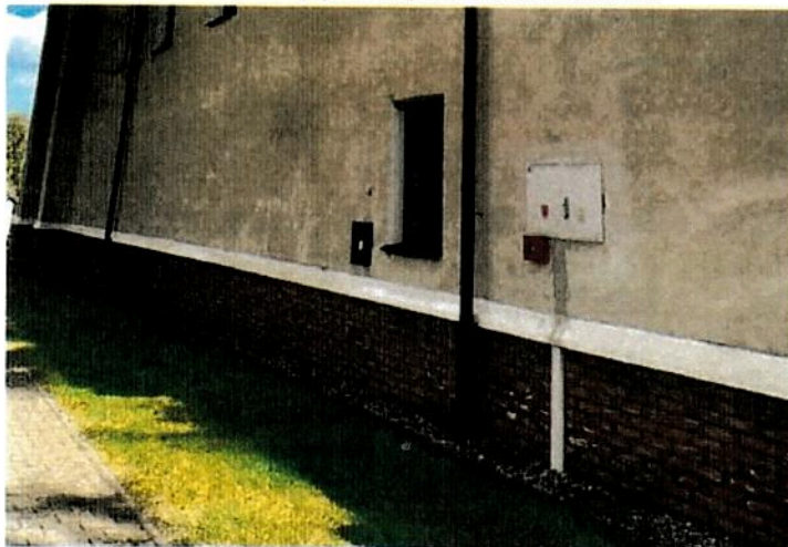
Fot. 4 Spękanie tynku strefy przycokołowej
