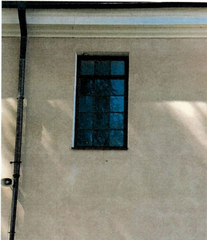
Fot. 2 Pęknięte tynki zewnętrzne w okolicy okien
