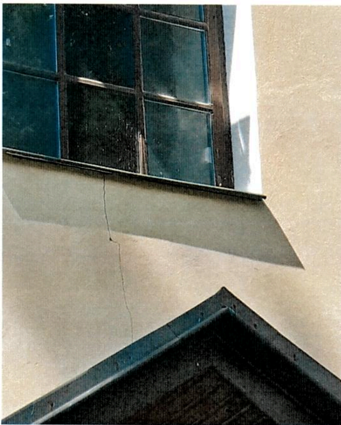
Fot. 1 Pęknięte tynki zewnętrzne w okolicy okien
