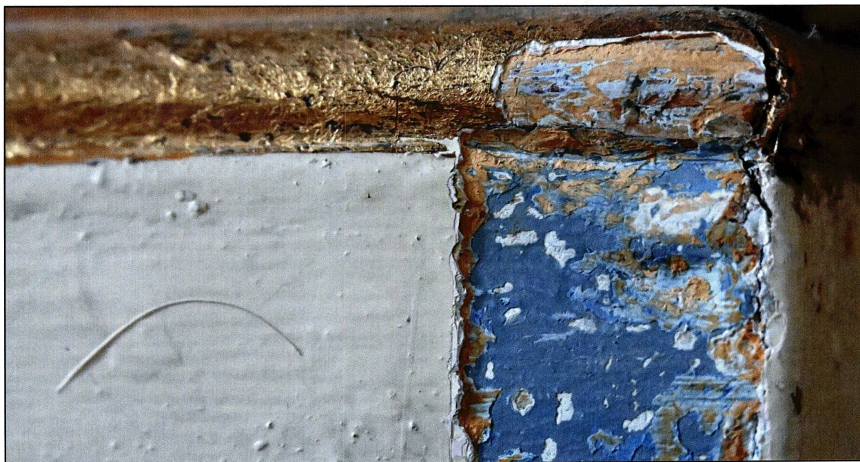
Fot. 18. Niestaranne przemalowania i wtórne „złocenia”. W odkrywcę widoczne przemalowania i brak oryginalnych gruntów pod złoceniami i, prawdopodobnie, ślady intensywnego żerowania owadów – korytarze i otwory wylotowe wypełnione wtórnymi gruntami.
